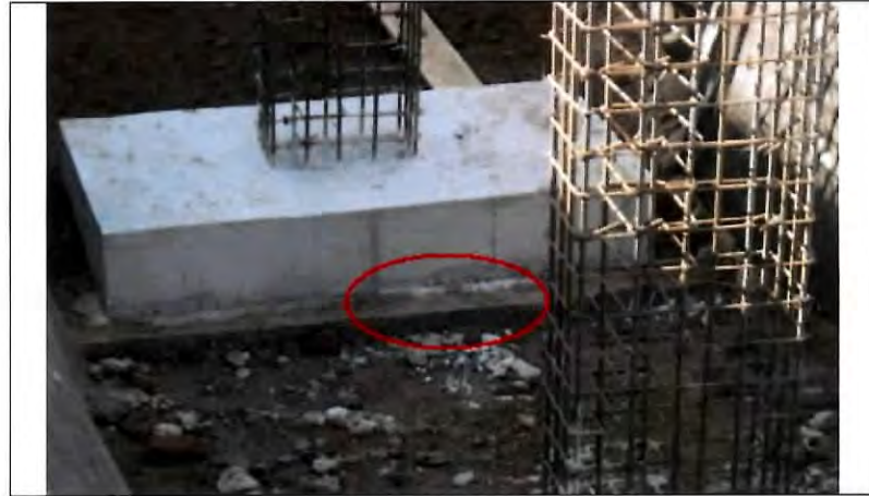
Fotografía N° 5: Discontinuidad producto de un Deficiente procedimiento de colocación y compactación del hormigón.
