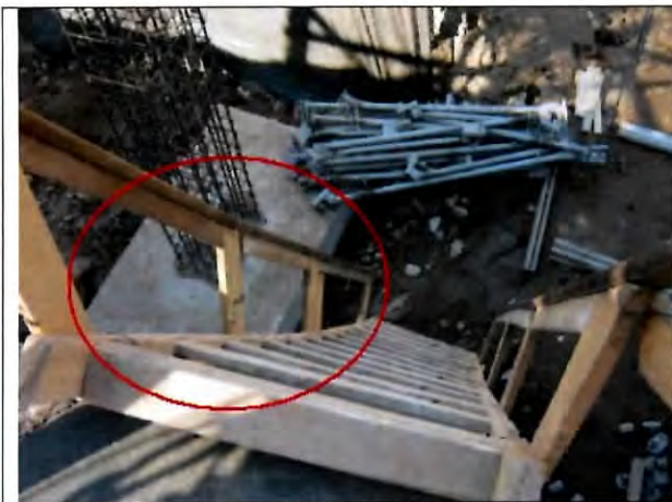
Fotografía N° 6 Condición Insegura en vías de circulación
