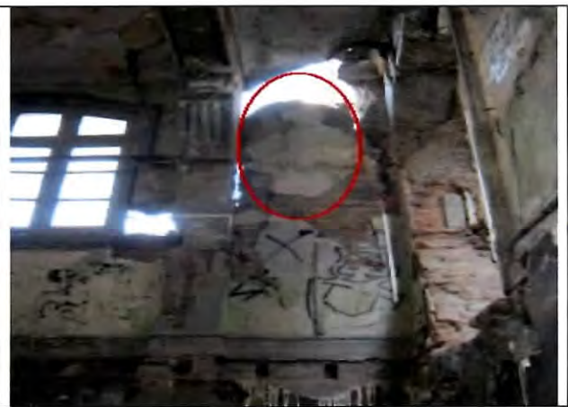
Fotografía N° 9 Riesgo de desprendimiento de hormigón
