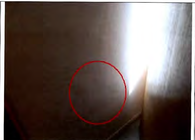
Fotografía N° 64 Se representa el lugar exacto donde debió de instalarse uno de los enchufes eléctricos del muro sur de la biblioteca.
