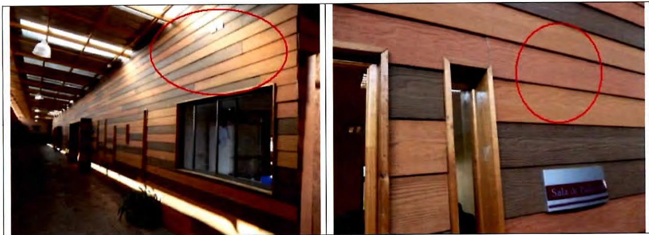
Fotografías N° 40 y 41 Cambio de materialidad, no regularizada en las terminaciones del revestimiento exterior, tipo martelina o elastomérico grano grueso.
