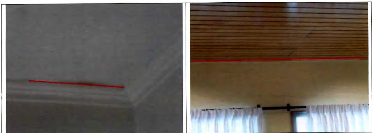
Fotografías N° 42 y 43 Falta de horizontalidad en cielos y cornisas.
