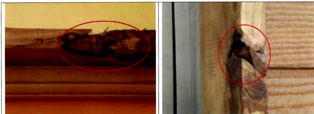
Fotografías N° 52 y 53 Utilización de madera de inferior calidad (con exceso de nudos, despuntes) en marcos base y perimetrales de vanos de ventanas de aluminio, pórticos y centros de puertas.
