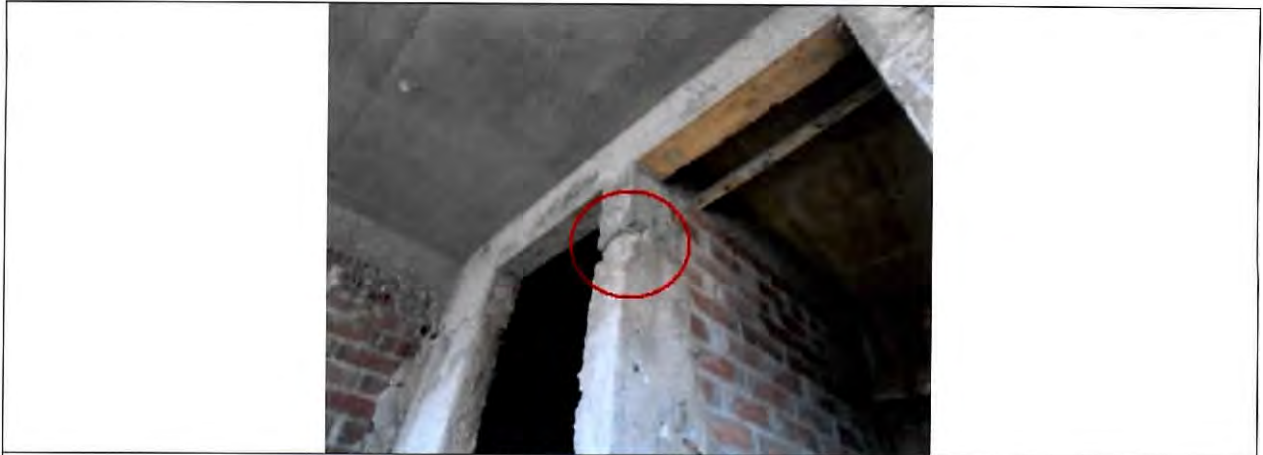
Fotografía N° 62. Discontinuidad por deficiente ejecución de junta de hormigón.
