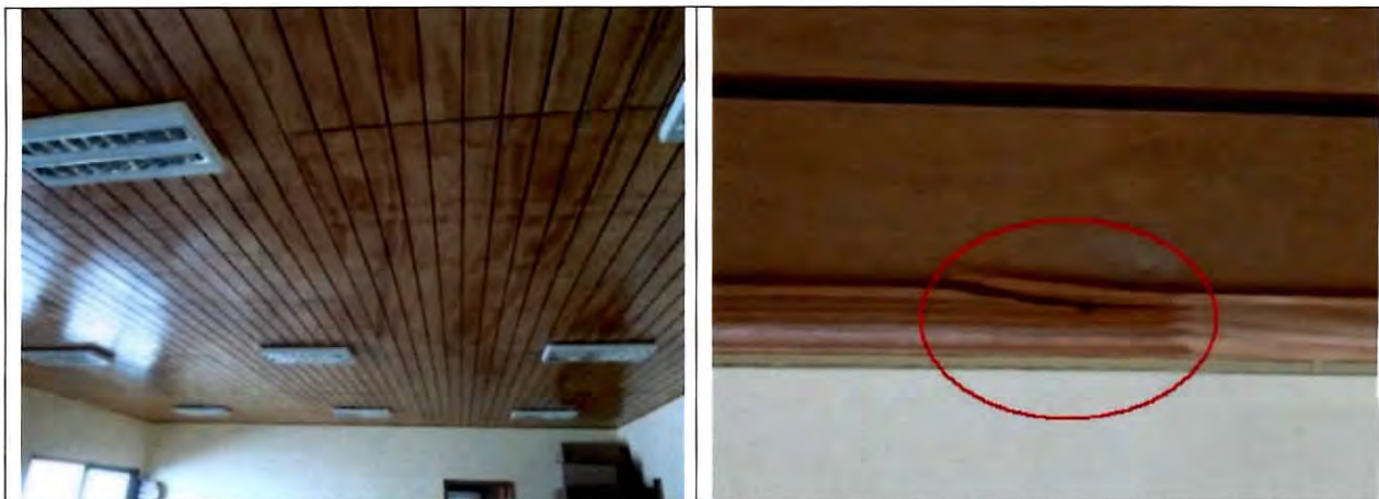
Fotografías N° 50 y 51 Deficiente colocación y fijación de cornisas de madera.
