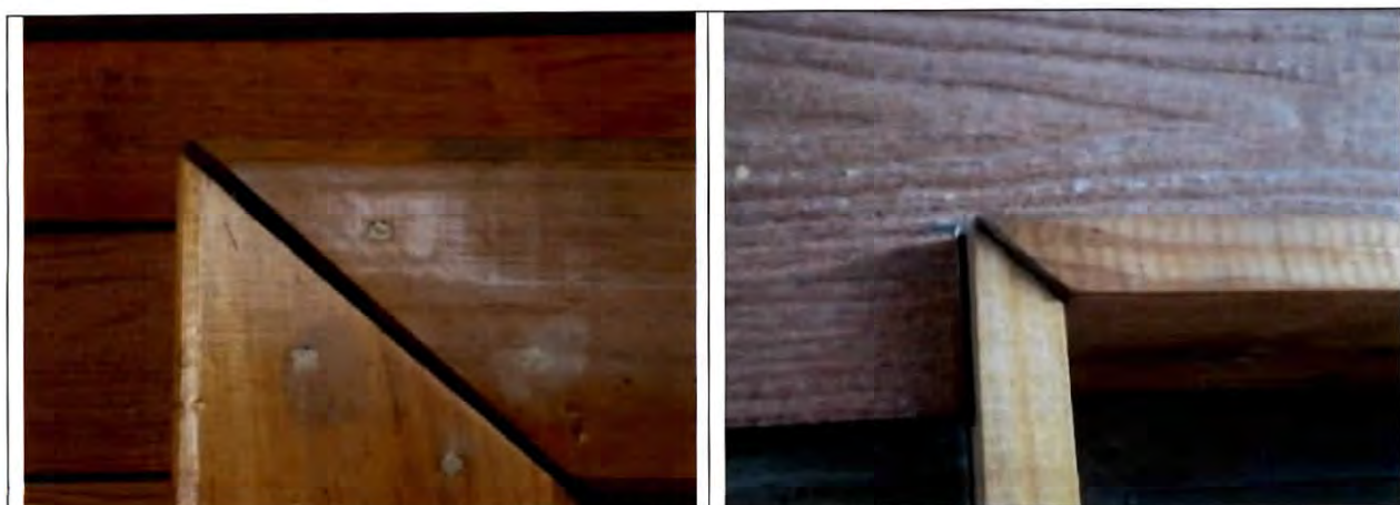
Fotografías N° 54 y 55 Deficiente terminación en vértices de ventanas y pórticos de madera (Falta cortes a 45°).
