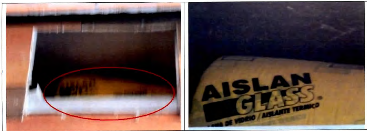
Fotografías N° 36 y 37 Deficiente tendido, ajuste y traslapo en el aislante térmico.
