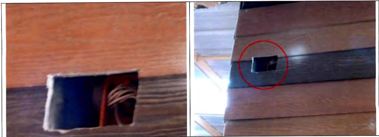
Fotografías N° 38 y 39 Falta terminación de la instalación eléctrica.
