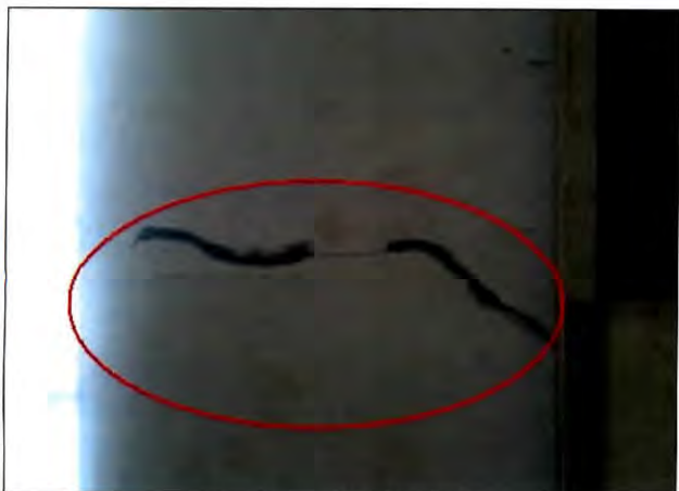
Fotografía N° 65 Grieta en el muro de la estructura del gimnasio.
