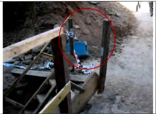
Fotografía N° 7 Condición Insegura por escalas provisionales de madera inestables y sin barandas.
