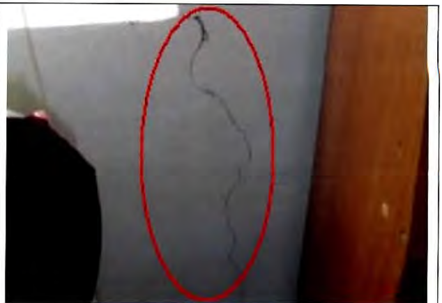
Fotografía N° 66 Grieta del muro del antepecho de la sala de la biblioteca.
