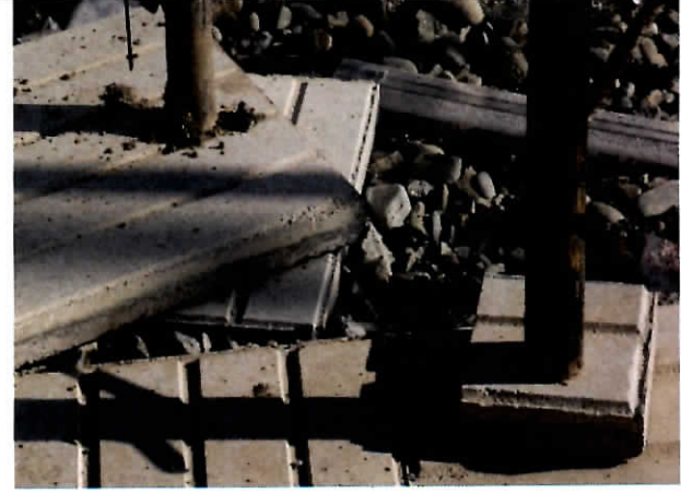
Fotografía N° 15: Apoyo de andamios sobre trozos de baldosa.
