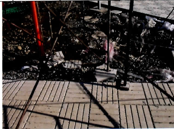
Fotografía N° 14: Apoyo de andamios sobre superficie irregular.
