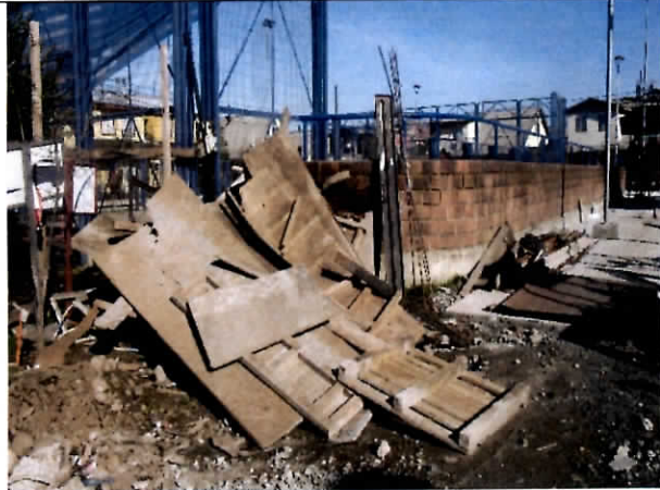
Fotografía N° 12: Desorden en acopio de materiales en obra.
