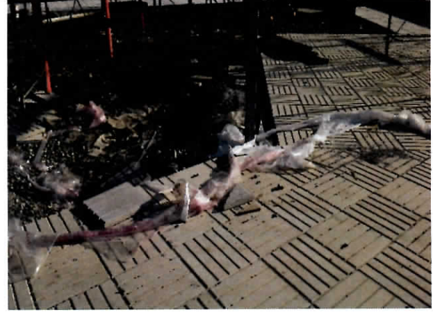
Fotografía N° 13: Restos de material y basura en la obra.
